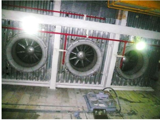
圖 8.2.4-22 五號緊急柴油發電機建築物內之通風口
