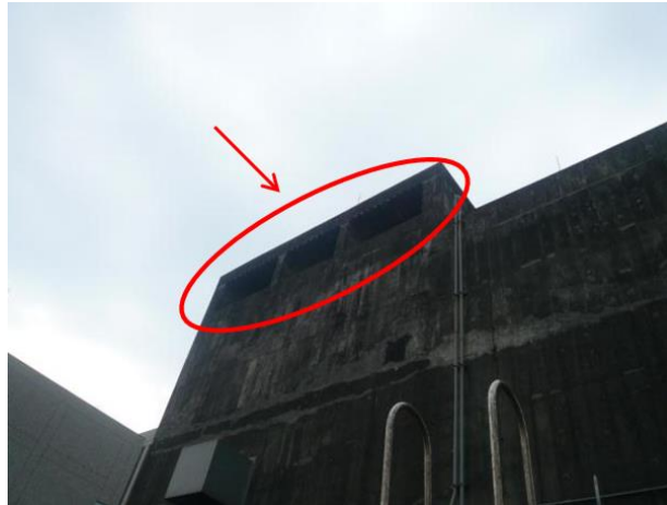
圖 8.2.4-23 五號緊急柴油發電機建築物內之通風口
