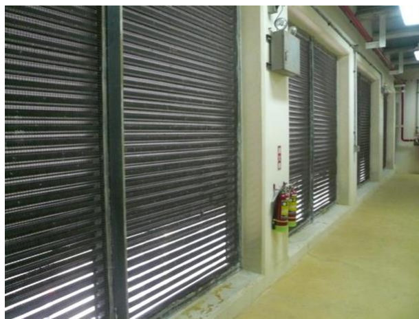
圖 8.2.4-24 五號緊急柴油發電機引擎冷卻口
